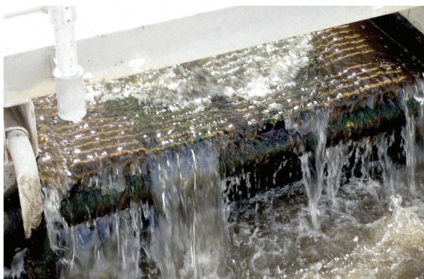
Planta de aguas residuales 2
