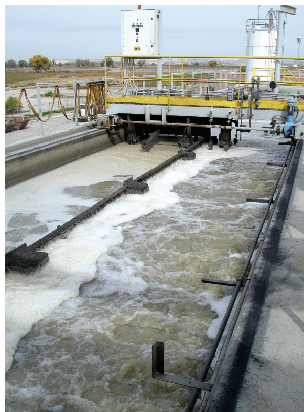
Planta de Aguas Residuales
