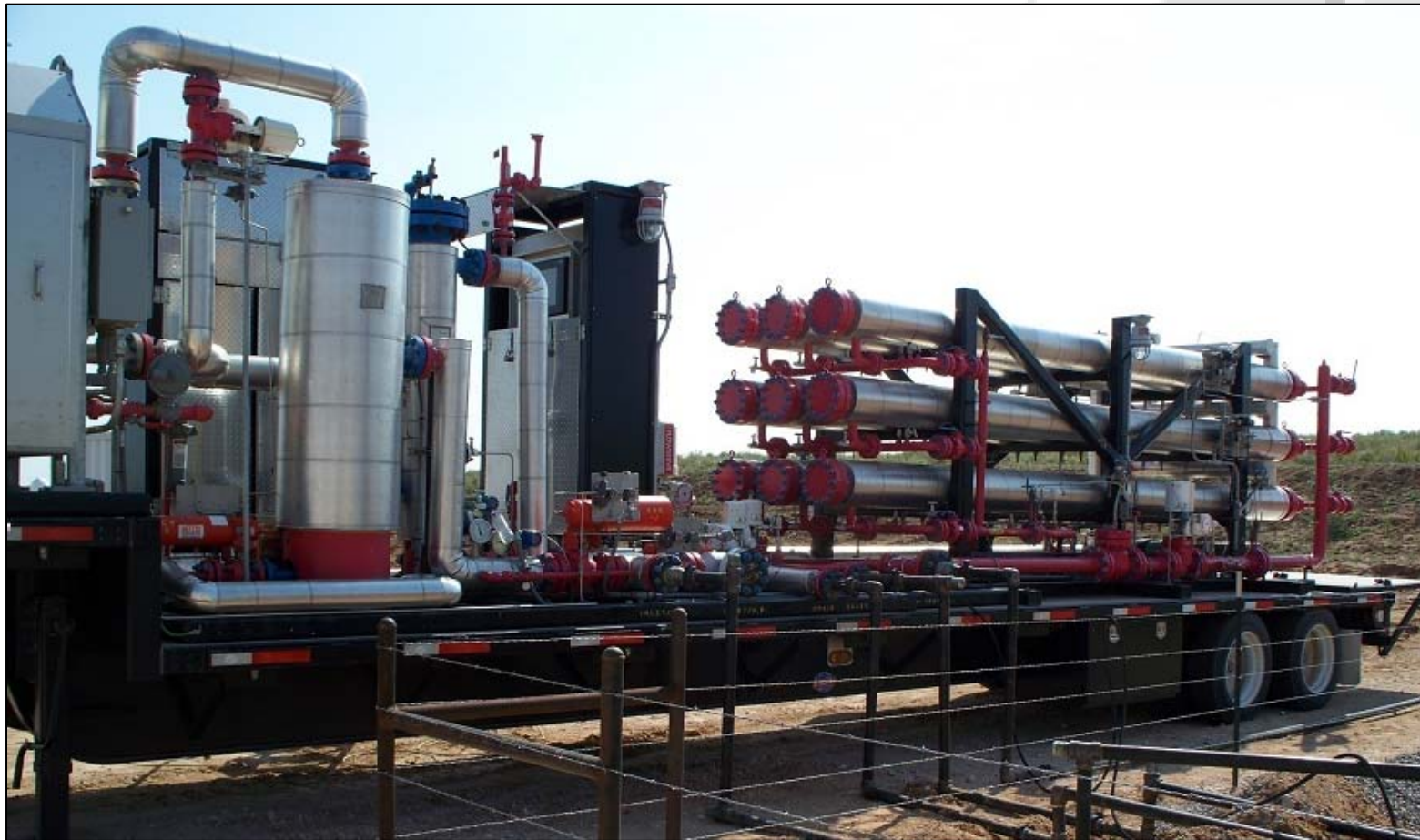
CO2 separation unit
