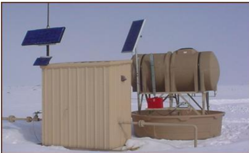
Источник: компания Anadarko, Химическая накачка на основе солнечной батареи
