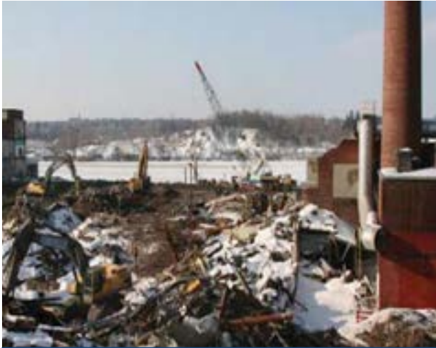
La fotografía muestra el sitio de Eastern Manufacturer Brewer, en Maine, antes de la limpieza
