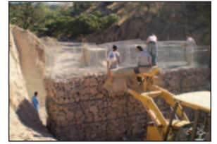
Estructura de detención de agua torrencial.
